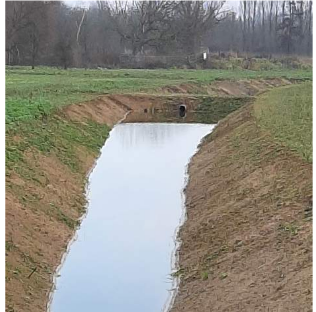
Buffer- en infiltratiegracht opgedeeld in verschillende panden met aarden dammen. Via een buis door de dam of het verlagen van de dam loopt het water weg als de gracht vol staat. (Foto: Hans Nuytens)
