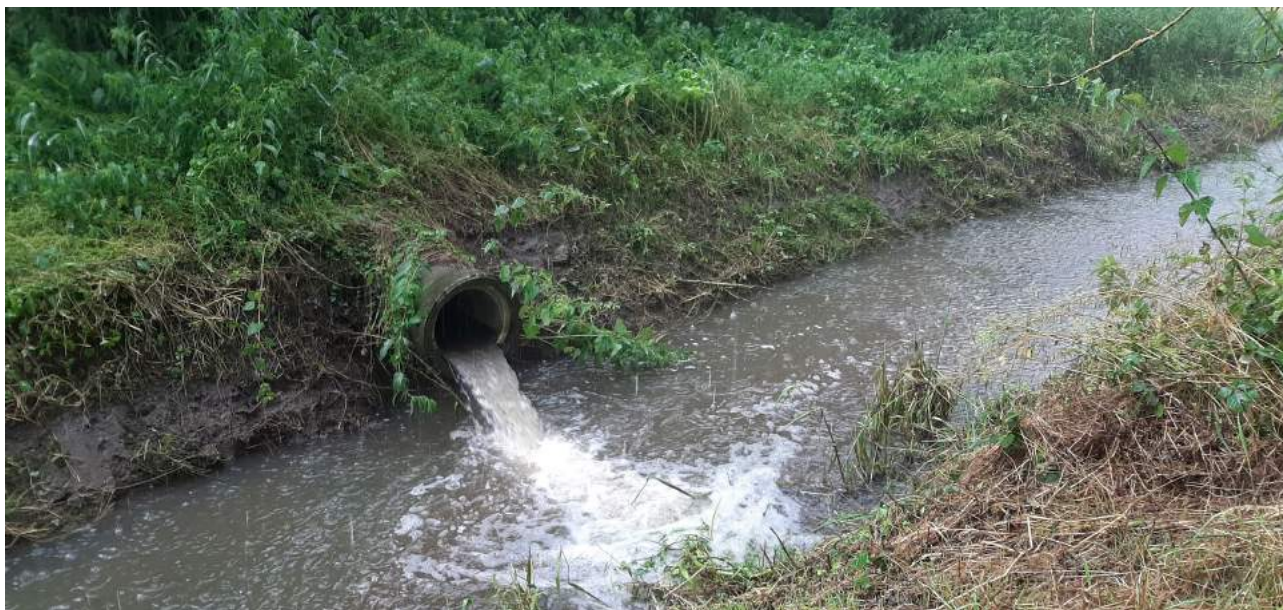
De afvoer van zo'n 7 000 m 2 verharde oppervlakte rechtstreeks naar de waterloop. (Foto: Hans Nuytens)
