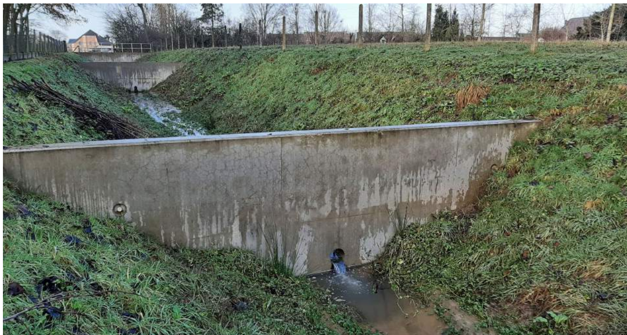
Buffergracht aan de Egaartbaan in Sint-Katherina-Lombeek. Die bestaat uit vier schotten met knijp. De laatste knijp heeft een afsluiter met een vlotter, waardoor de gracht bij hoge debieten ook functioneert als een wachtbekken. (Foto: Hans Nuytens)
